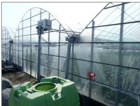
防犯カメラの設置
