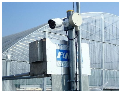
防犯カメラの設置
